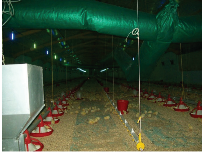
Şekil 8. ISINAN HAVANIN KÜMERE BRANDA BORULARLA GÖNDERİLMESİ
