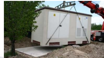
Trafo ve Şebeke Bağlantı
