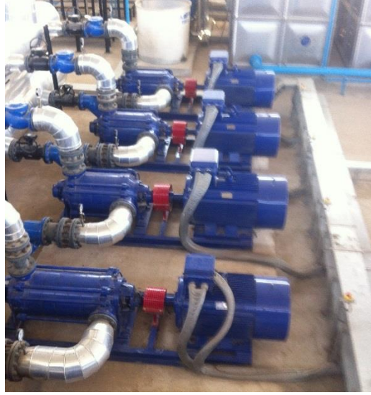
Şekil 8.3. Örnek Bir Pompa İstasyonundan Görünüm
